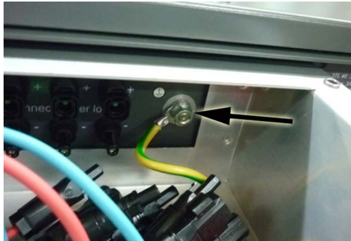
Bild 30: Interne PE-Verbindung der ConnectionBox herstellen
